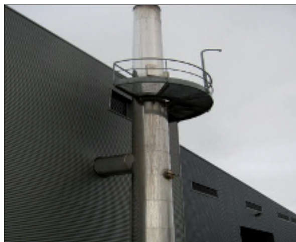
Point de mesure des rejets atmosphériques.
