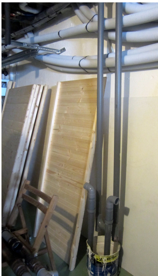
Photo 3. Le système de récupération de la chaleur des eaux usées.
